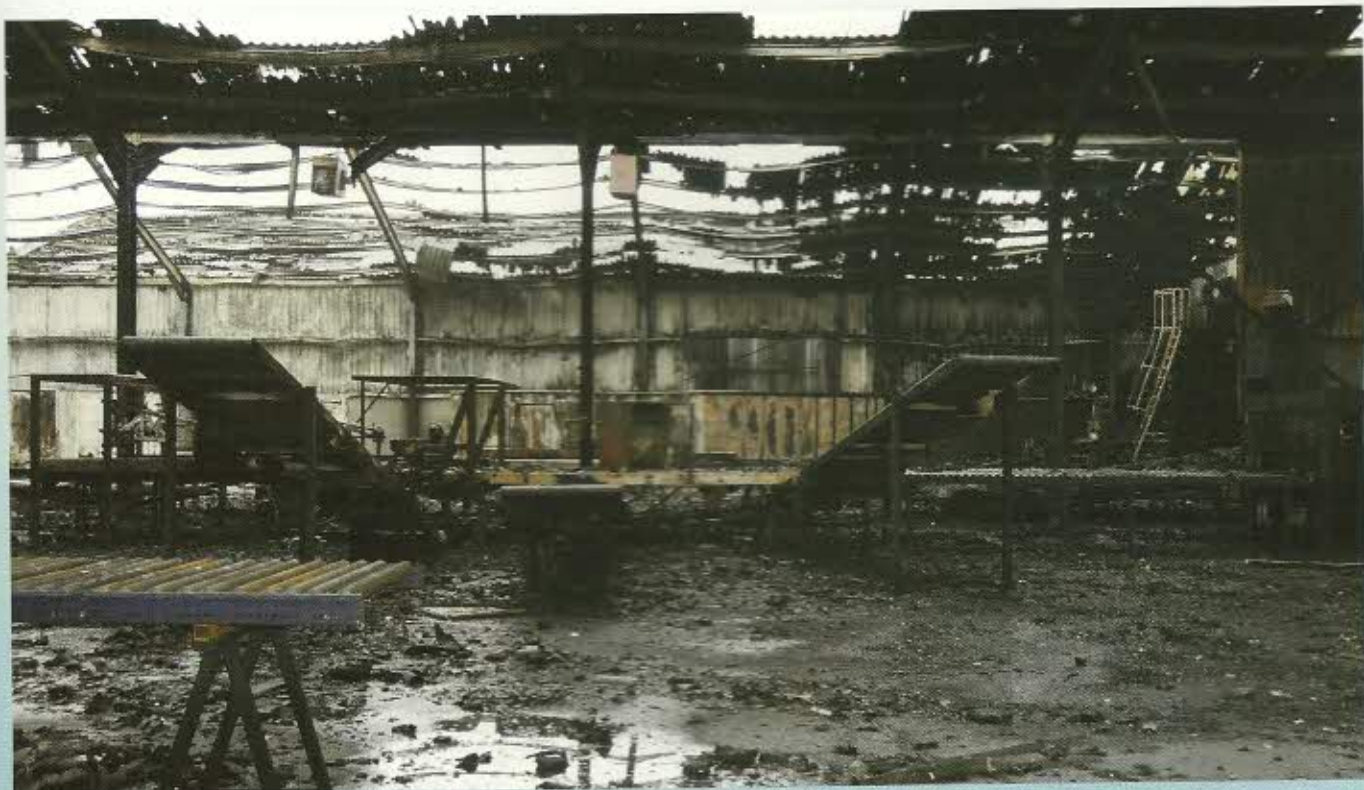
Weinig rest nog van de locatie en installaties van RetourMatras. De brand heeft behoorlijk huisgehouden. (Foto: Fred Docter)
